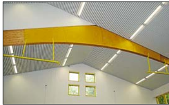
An diesem äußeren Dachbalken wurden die ersten Risse entdeckt. Die Stadt zögerte nicht lang und ließ die Halle sofort sperren.
