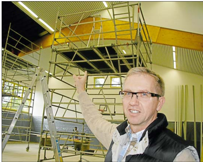
Zeigt auf die Leimbinder, die in den vergangenen Wochen von der norddeutschen Firma Schütt saniert worden sind; der städtische Bauexperte Reinhard Pawel. Die Risse wurden mit Epoxidharz aufgefüllt. Von außen wurden noch zusätzliche Platten für mehr Stabilität angebracht. Bilder: Frerick
